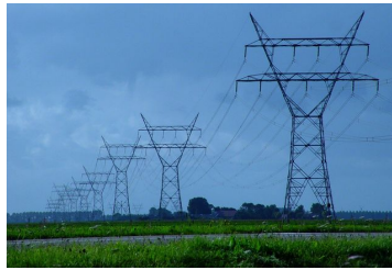
Slika 26.3 Daljnovodi. Žice so pod visoko izmenično napetostjo. Po njih se pretakajo izmenični tokovi. Daljnovodi prenašajo električno energijo od generatorjev do oddaljenih potrošnikov. (Anon)
